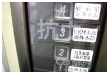
エレベーターのボタンに
